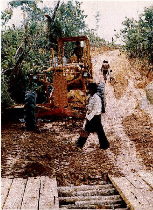
PEMBUATAN JALAN DAN JEMBATAN SEPANJANG 34 Km. YANG MENGHUBUNGAN ANTAR DESA RESETTLEMENT. ( GAMBAR 6 ).
