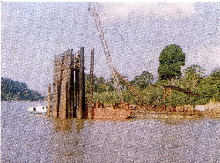
PEMBANGUNAN JEMBATAN WAY TENUMBANG (TULANG BAWANG) DAN APABILA SELESAI AKAN MEMPERMUDAH HUBUNGAN MENGGALA DAN DAN DAERAH TRANSLOK YANG BERARTI TERBUKANYA DAERAH TERISOLIR. ( GAMBAR 8 ).
