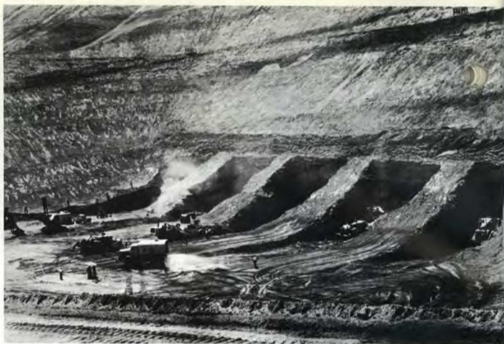
FIG. 3 — PAKISTAN — Des excavatrices commencent à creuser les tunnels de détournement de la rivière Jhelum dans le cadre du projet hydraulique de Mangla, au Pakistan occidental. Ces travaux, au financement desquels la Banque Mondiale et sa filiale, l'Association Internationale de Développement, participent, sont une partie du plus grand système d'irrigation du monde, le plan de la vallée de l'Indus. Le barrage de Mangla a été terminé en novembre 1967.
